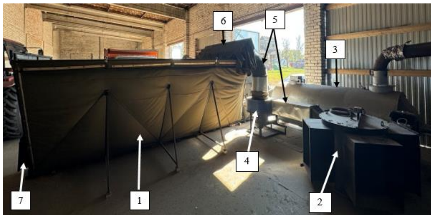
Рисунок 13 – Аэродинамическое устройство для сушки сыпучих материалов, оснащенное разработанной системой рециркуляции агента сушки в ЗАО «Шунга» Костромской области: 1 – камера сушки; 2 – клапан-смеситель системы рециркуляции; 3 – теплогенератор; 4 – вентилятор аспиратор системы рециркуляции; 5 – воздуховоды; 6 – сдвижной зонт камеры сушки системы рециркуляции
